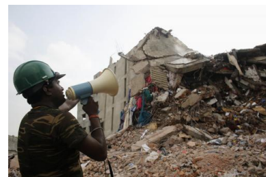
Un sauveteur cherche des survivants dans les décombres du Rana Plaza, le 30 avril 2013. © Reuters
